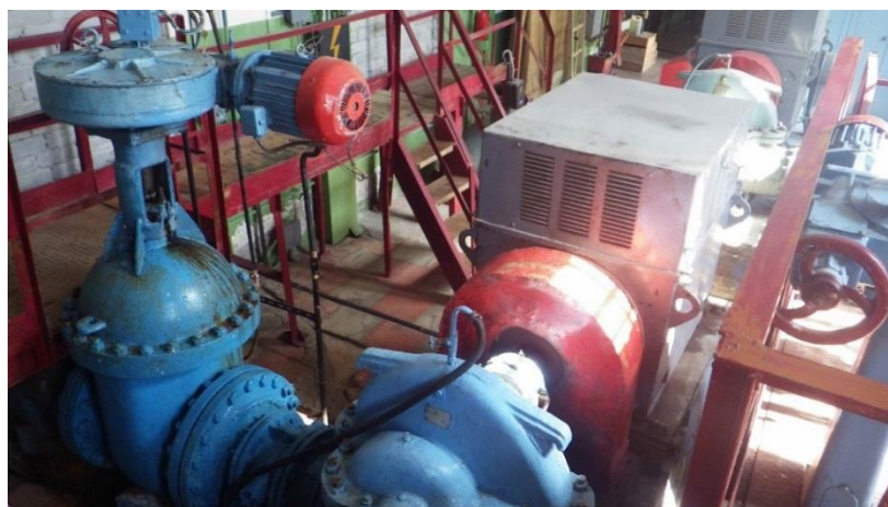
Рисунок 7. Насосное оборудование НС-2 водозабора «Центральный»
