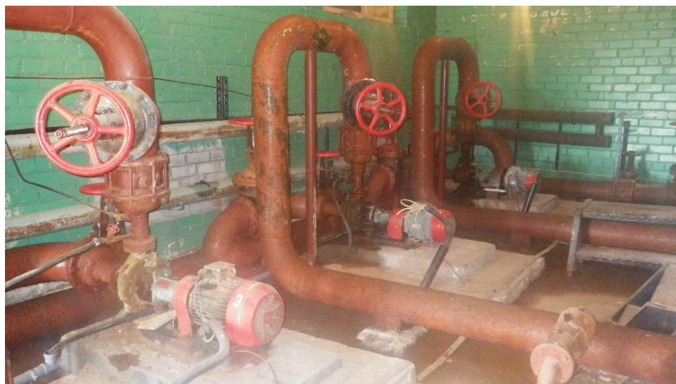
Рисунок 11. Насосное оборудование НС-3 для подачи воды в 11 микрорайон.
