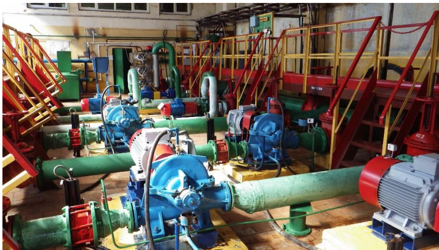
Рисунок 12. Насосное оборудование НС-2 н.п. Коашва.
