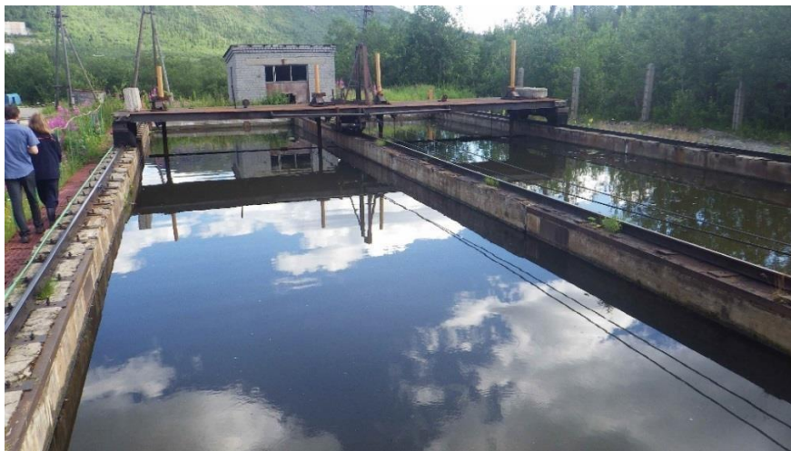
Иловые площадки-уплотнители – 14 ед. (рисунок 25)
