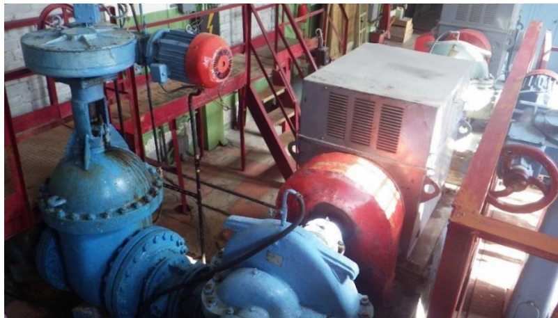
Рисунок 7. Насосное оборудование НС-2 водозабора «Центральный»
